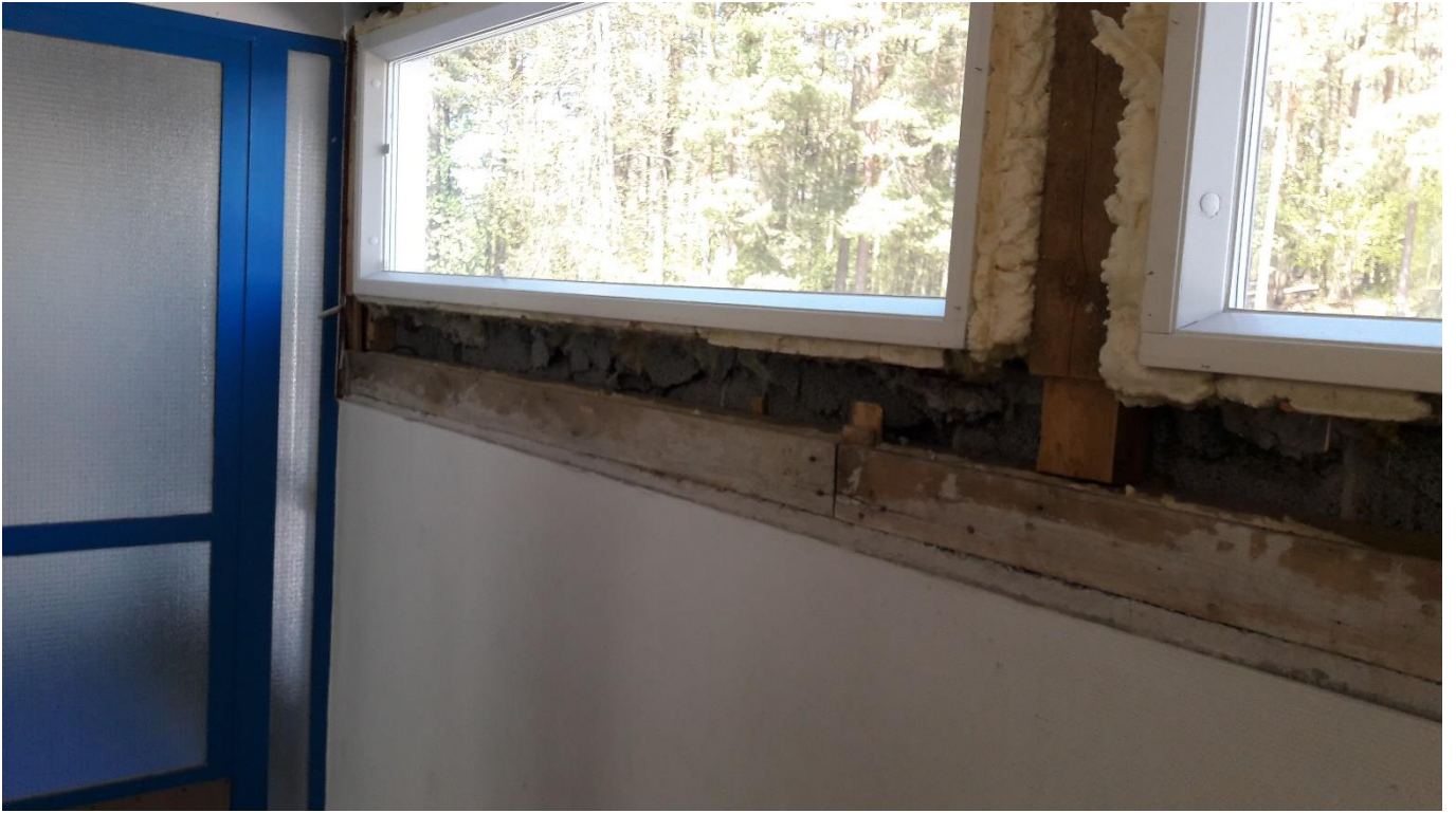
Käytäväseinän vanha rakenne. Käytetty vanhaa muottilautaa. Rakenne uusittiin.
