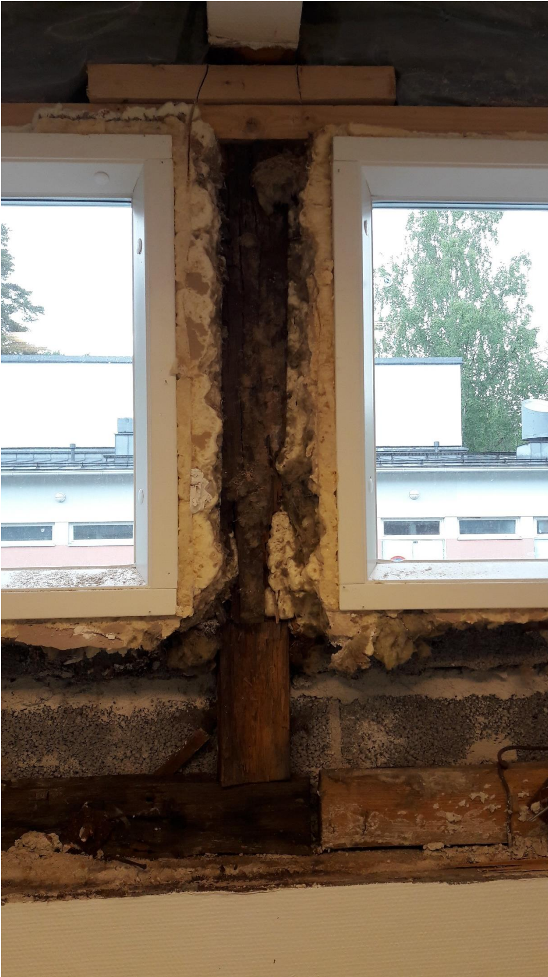
Vanhaa lahovauriota siiven siiven toiselta osalta (itäpuolelta). Lahovauriokohdat olivat avaushetkellä kuivia.
