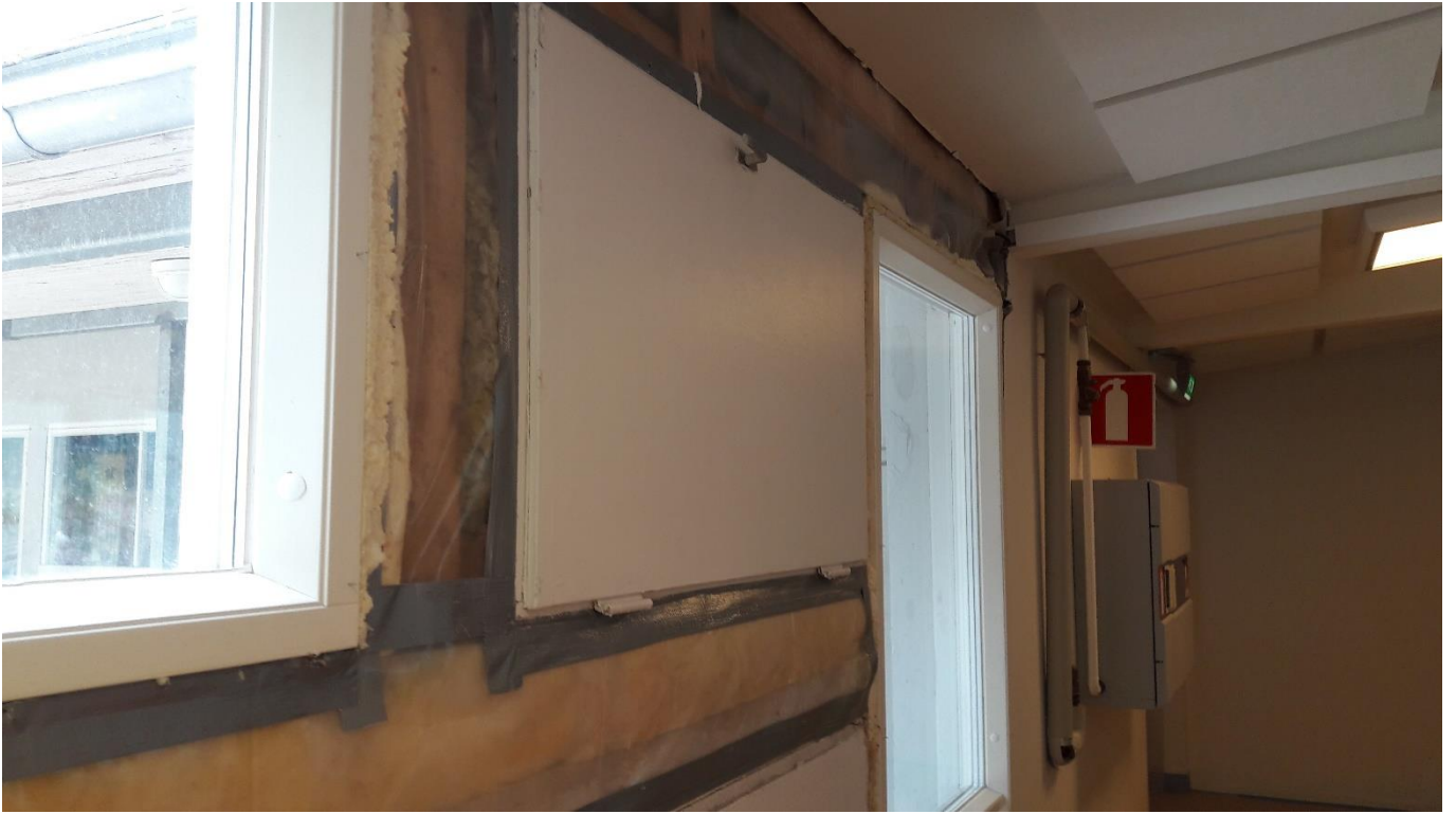
Käytävän puutteellista höyrynsulkua.
