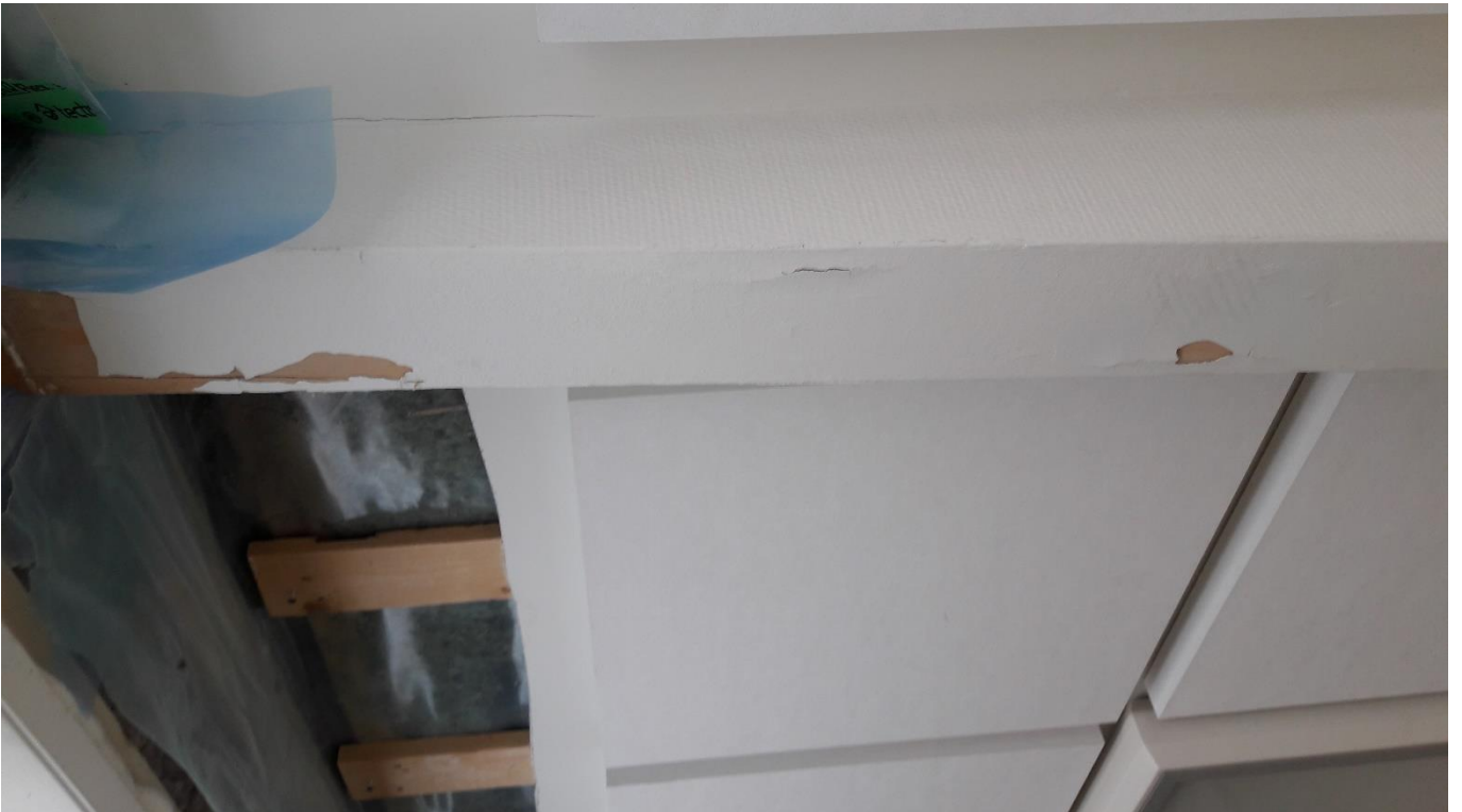
Kattokannattajien kosteus mitattiin maalilohkeilun takia. Kattokannattajat olivat kuivia.
