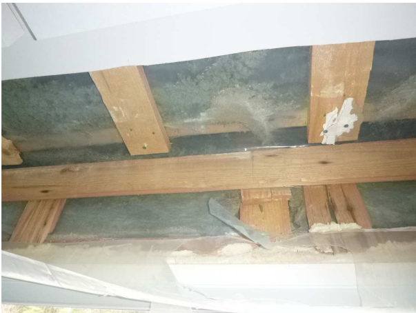
Kuva 1. Käytävän ulkoseinän höyrynsulku on epätiivis ja puurakenteissa kosteusvaurioita
