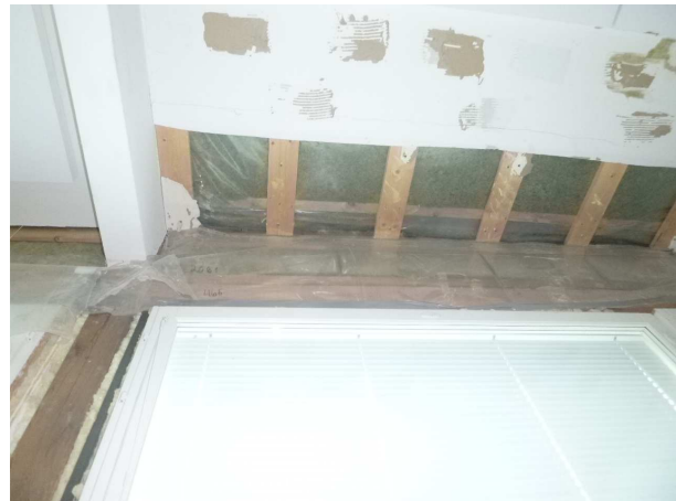
Kuva 2. Luokkahuoneen ulkoseinän ja yläpohjan höyrynsulun liittymä on epätiivis.
